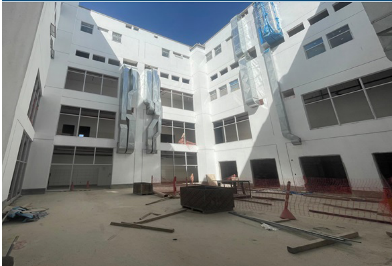
El hospital Maritza Campos ha sido paralizada en varias oportunidades. Casi la mitad de su presupuesto proviene del canon y regalías.
